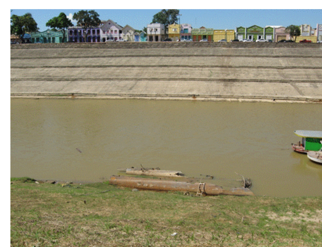
Figura 6. Encostas impermeabilizadas e assoreamento do rio.
